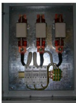
Рисунок 17 - Элементы молниезащиты от перенапряжений в электрораспределительном щитке
